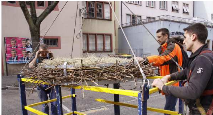
L'entreprise Schaechtelin s'est occupée de l'installation et a construit la structure métallique du nid. C'est une habituée de ce genre d'opérations. PHOTO DNA - ALETH ARRÍAS-CAMPS
